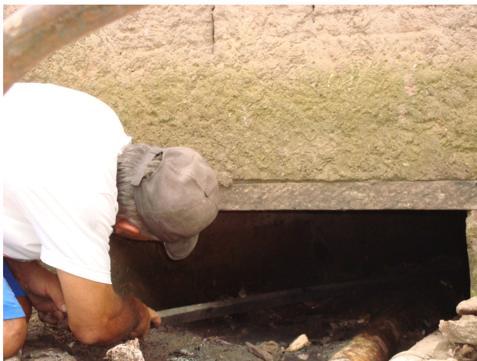
Fotografia 4 – Entupimentos constantes, com sérias conseqüências para as residências.
