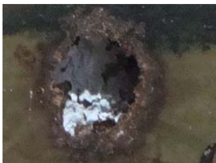
FIGURA 128 - Detalhe. Pontos de ferrugens ampliados - Suporte, folha de flandres.
