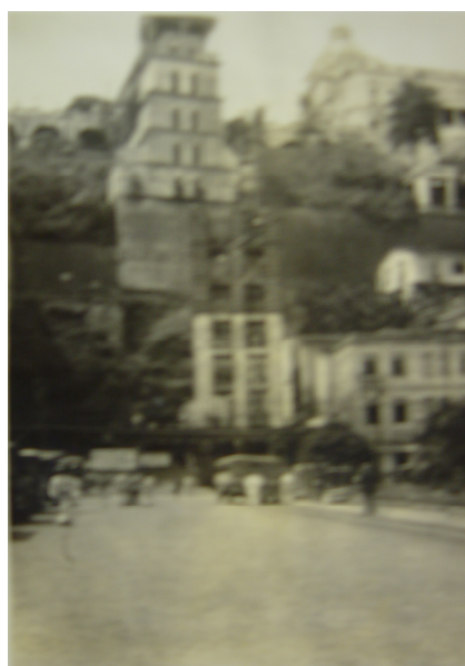
Figura 47 - Construção da parte inferior do Elevador Lacerda. Final da década de vinte. Acervo Coelba
