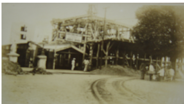
Figura 46 – Construção da parte superior do Elevador Lacerda. Final da década de 20. Acervo Coelba.
