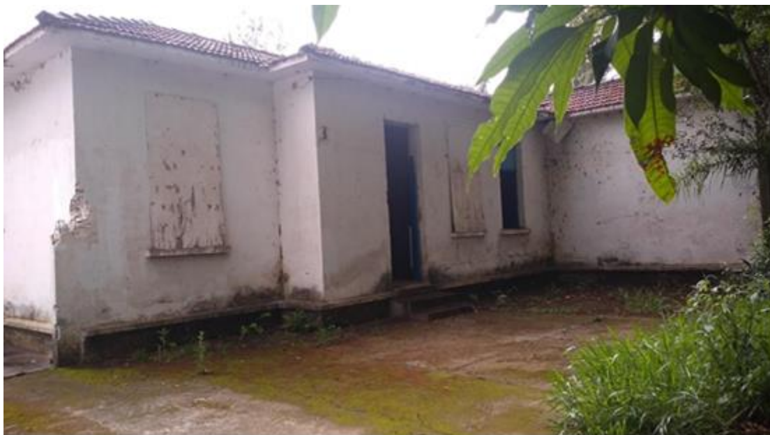
FIGURA 44- Fotografia do atual estado da edificação que era utilizada pela antiga Escola de Moços e Moças Nossa Senhora das Graças
