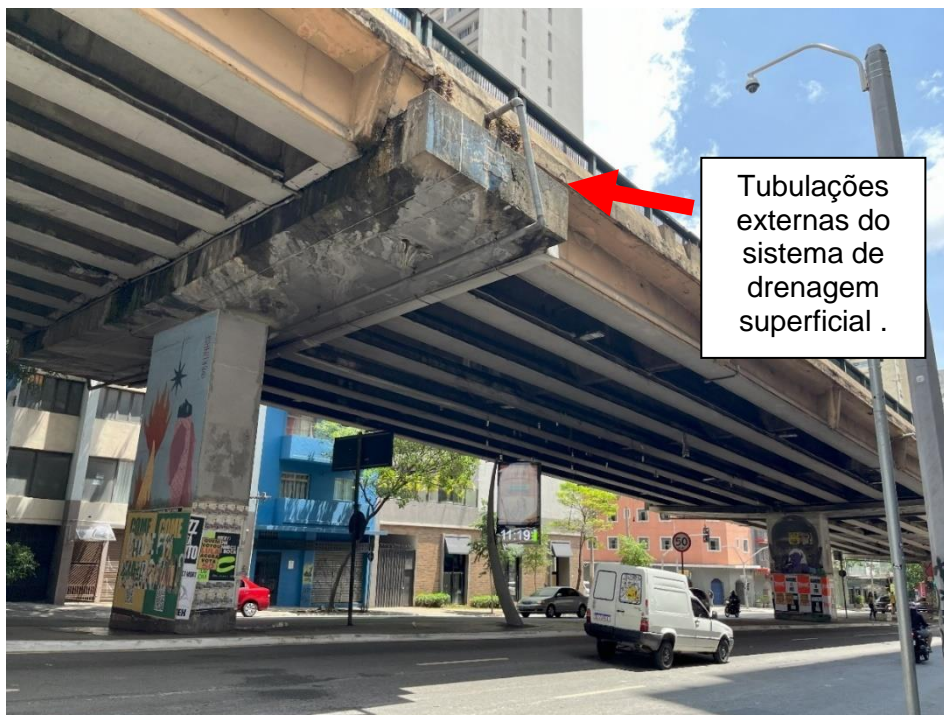
Figura 71: Sistema de drenagem.
