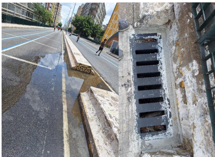
Figura 72: Obstrução das bocas de lobo.
